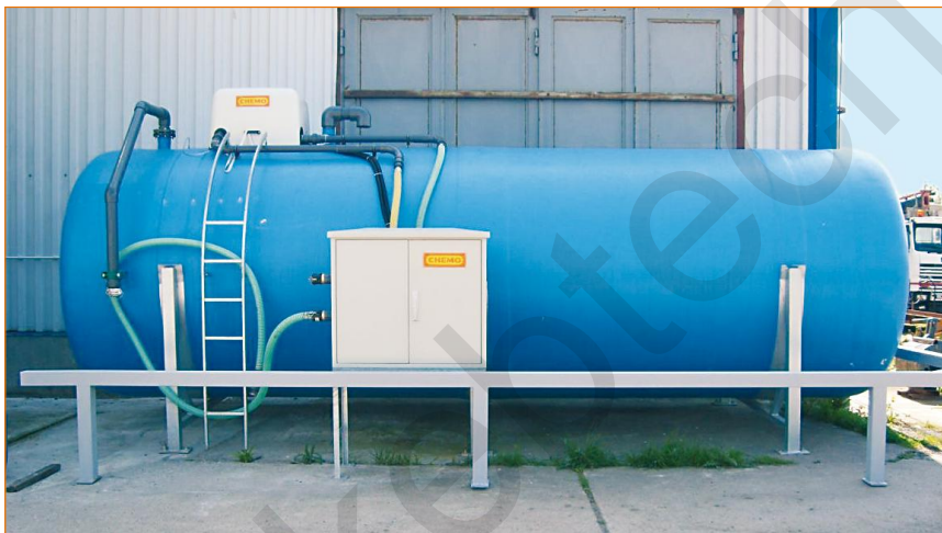
Komplettan összeállított sósvíz tároló szivattyú egységgel
